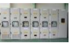
配電盤 (華城、中興電工、東元)
